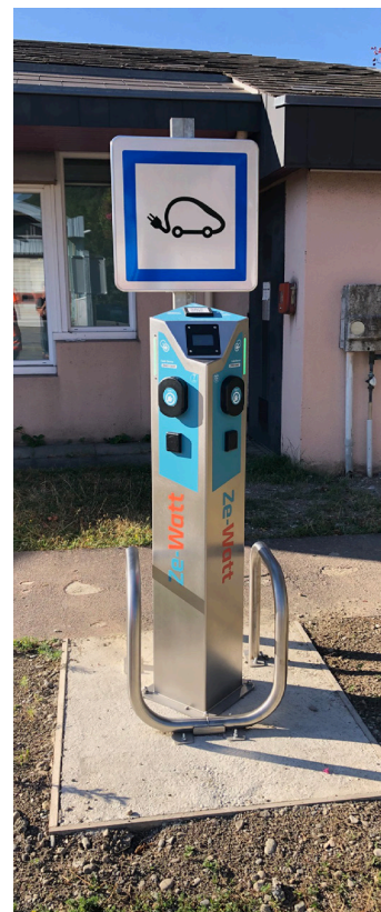
Borne installée au CEI de Grenoble
